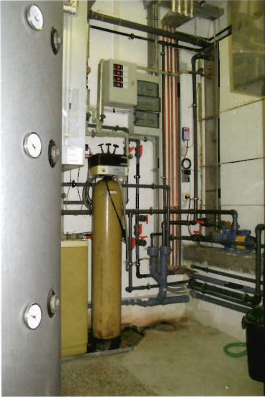
Bild 2: Das Herzstück der Anlage mit dem E-Schaltkasten und der Temperaturregelung der einzelnen Heizkreisläufe. Links ist der große vorgeschaltete Ionentauscher zu sehen.
