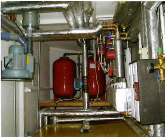
Bild 3: Diese Aufnahme zeigt die gesamte Solarsteuerung auf vier Heizkreisläufe mit der Luftpumpe für die zentrale Luftversorgung.
